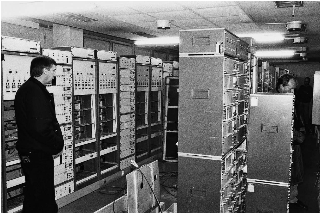
Bild 26 Blick in einen der Räume mit Technik. Foto A. Graubner
